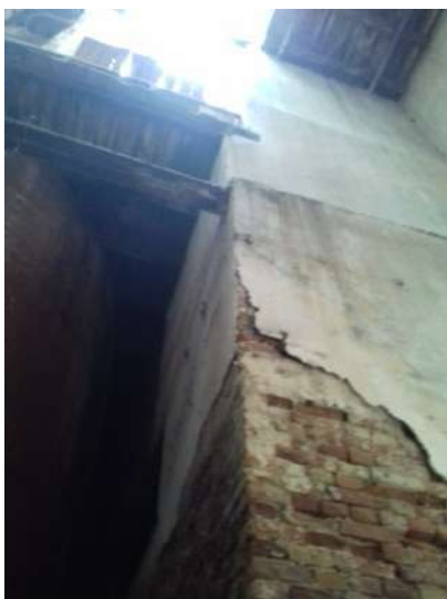
Рис. 2. Состояние кирпичных стен
